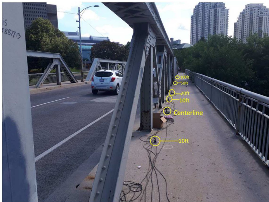
Capteurs installés sur le pont
